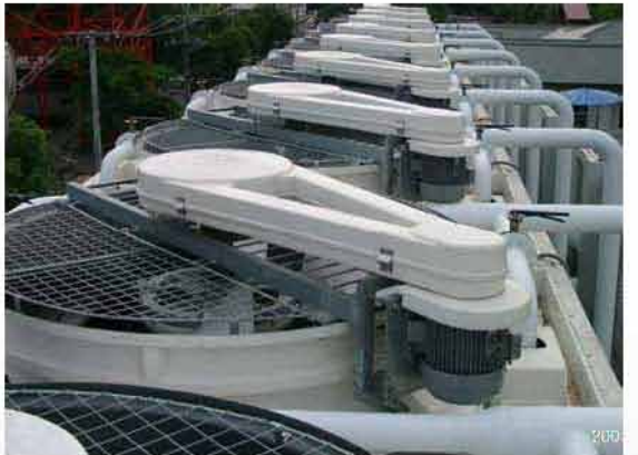
หอระบายความร้อน (Cooling Tower)
