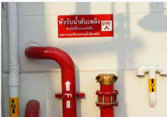
หัวรับน้ำดับเพลิง
