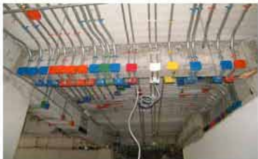
กล่องไฟฟ้า (Box)
