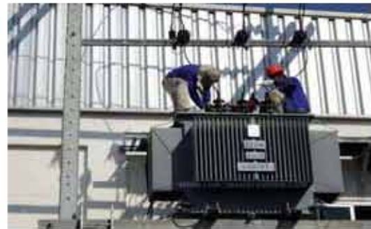
หม้อแปลง Oil Type ติดตั้งบนผนังบ้าน
