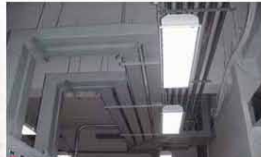
รางเดินสาย (Wireway)
