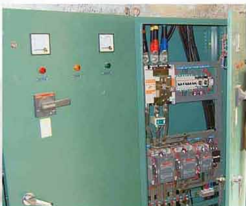
ตู้ควบคุม
