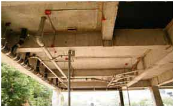
ท่อไฮดรอก(เหล็กหล่อ) ท่อน้ำเสีย(เหล็กอาบสังกะสี)
