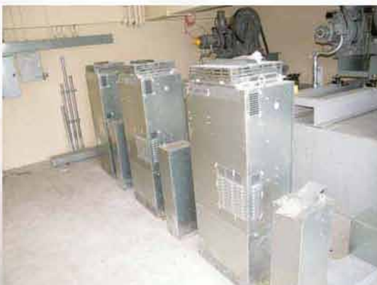
ภายในห้องเครื่องลิฟต์
