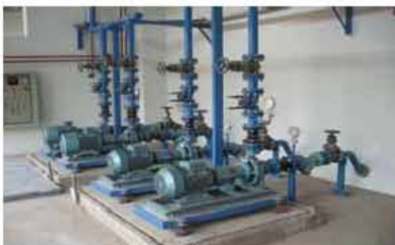
เครื่องสูบน้ำประปา
