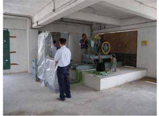
ตู้ควบคุมและเครื่องจักร
