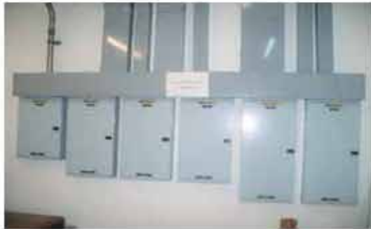
ตู้ Load Center
