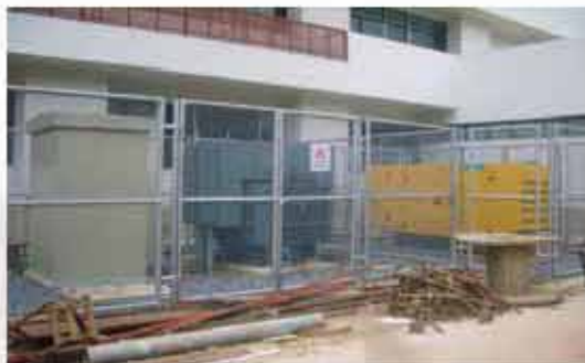
หม้อแปลง Oil Type ติดตั้งในรั้ว
