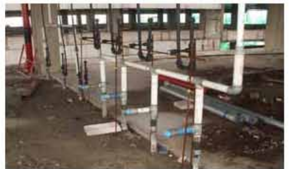
ท่อรับน้ำเสียและท่อน้ำประปา
