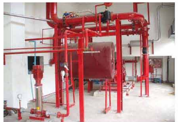
เครื่องสูบน้ำดับเพลิง
