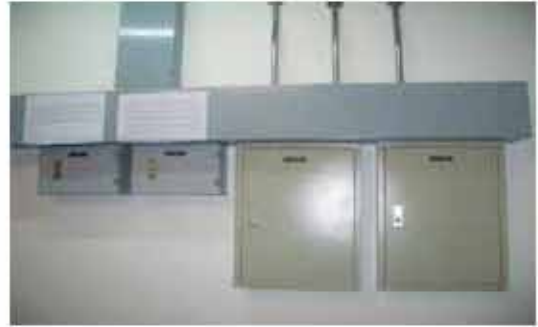
ตู้ Load Center
