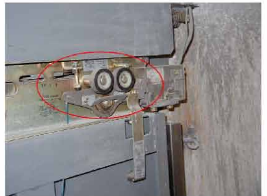
ตรวจสอบ Limit Switch ควบคุมเปิด-ปิดประตู
