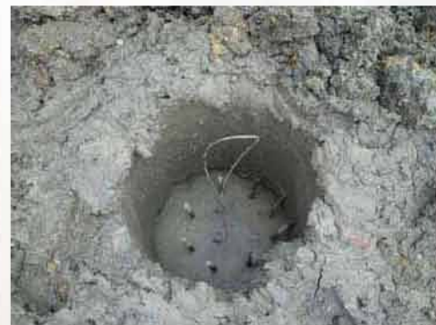
สภาพคอนกรีตหัวเสาเข็ม
