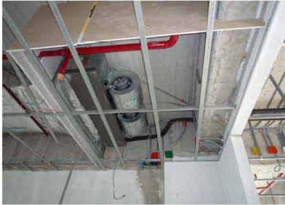
Fan Coil Unit
