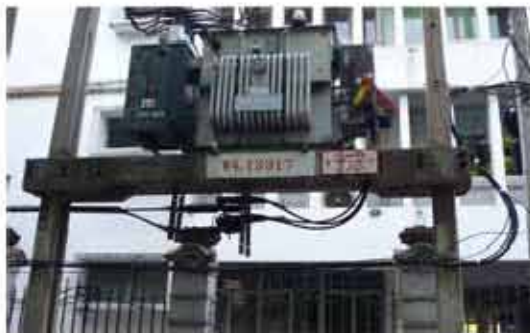
หม้อแปลง Oil Type ติดตั้งบนผนังบ้าน
