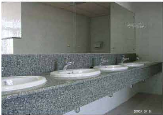
อ่างล้างหน้าและอุปกรณ์
