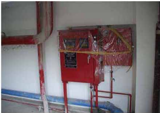
ตู้ควบคุมเครื่องสูบน้ำดับเพลิง
