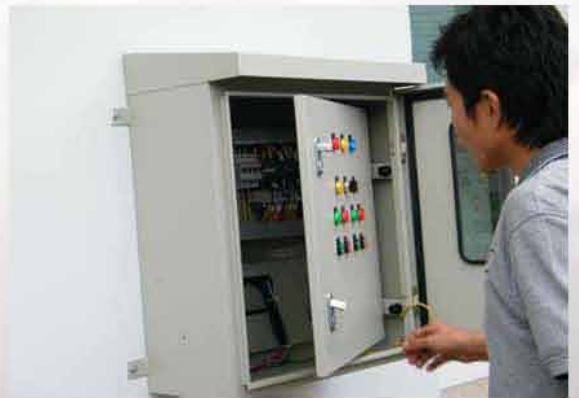
ตู้ควบคุม
