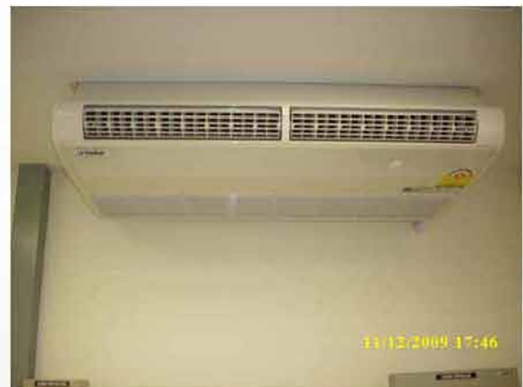
Fan Coil Unit
