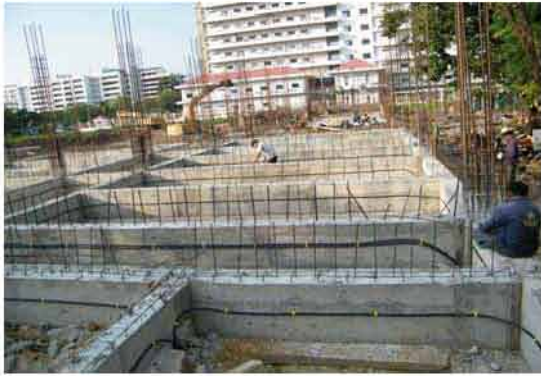
ท่อน้ำยากำจัดปลวก
