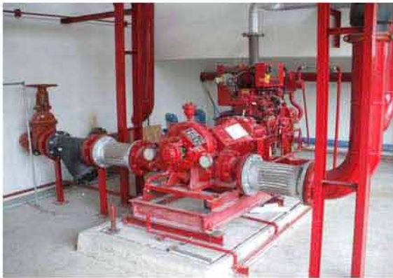
เครื่องสูบน้ำดับเพลิง
