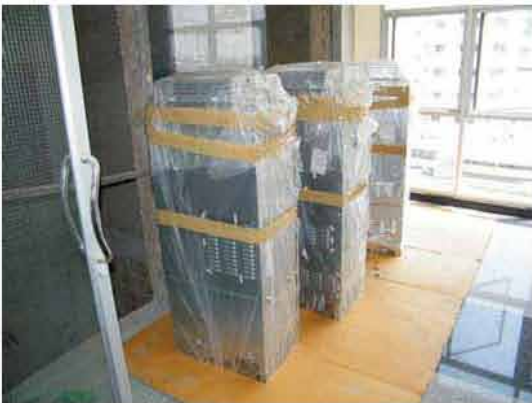
ตู้ควบคุม
