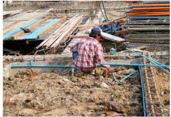
ท่อน้ำยากำจัดปลวก
