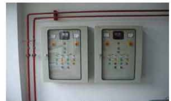
ตู้ควบคุมเครื่องสูบน้ำประปา
