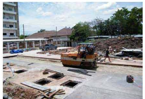
บ่อบำบัดน้ำเสีย คสล.
