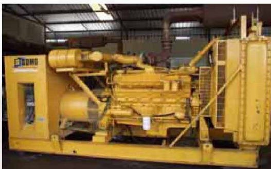
เครื่องกำเนิดไฟฟ้าสำรองติดตั้งในอาคาร
