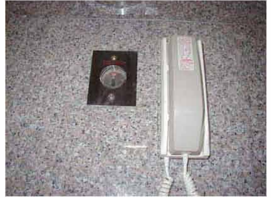
ตรวจการทำงานของ Fire Switch
