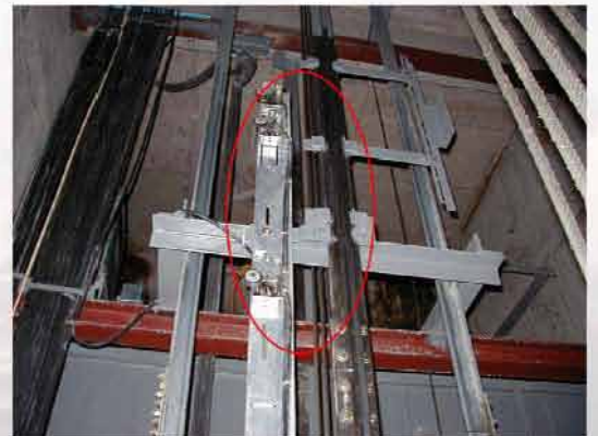
ตรวจสอบ Limit Switch ควบคุมการจอด
