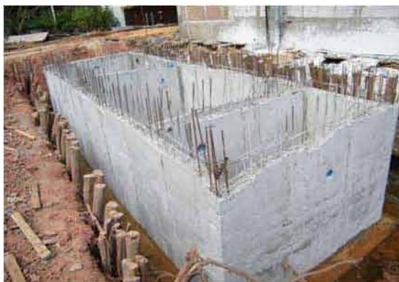
บ่อบำบัดน้ำเสีย คสล.
