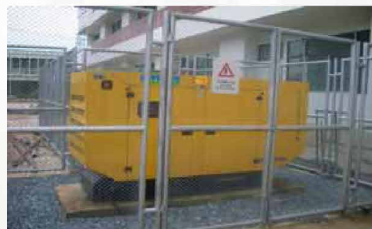
เครื่องกำเนิดไฟฟ้าสำรองติดตั้งนอกอาคาร
