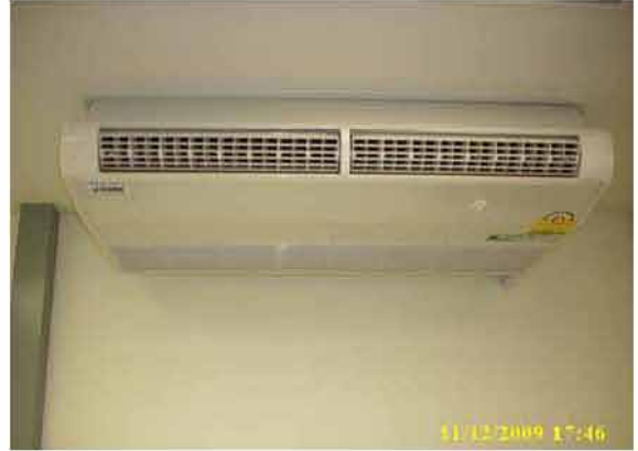
Fan Coil Unit
